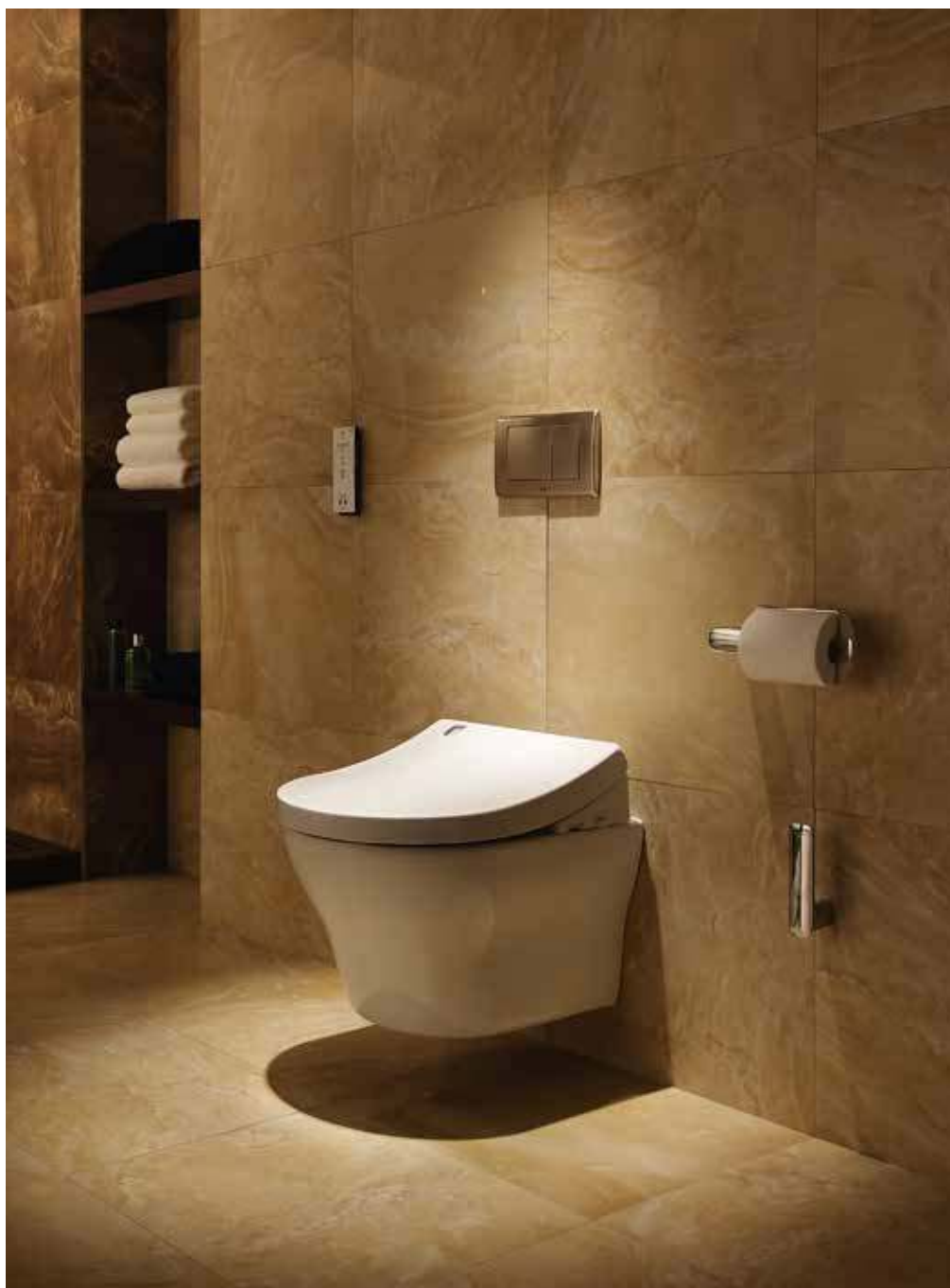
WASHLET™ 4732 (TCF4732G) с подвесным унитазом MH (CW162Y)
